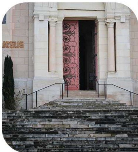
Église Les peintures intérieures de l'église sont menacées : une étude de restauration s'impose.
