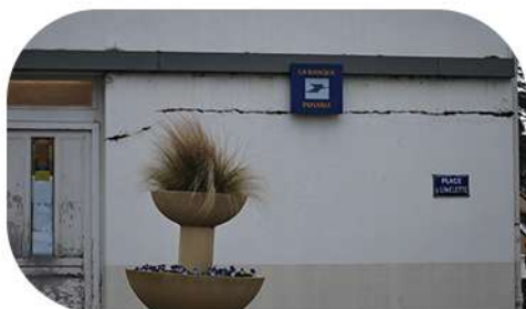
Bureau de poste Façade fissurée Entretien insuffisant
