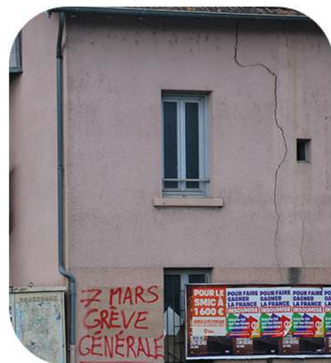
Centre social Mosaïque Ancien bâtiment face au cycle Rolland laissé à l'abandon. Devenu insalubre et dangereux. Sa démolition aurait dû être engagée depuis plusieurs années.
